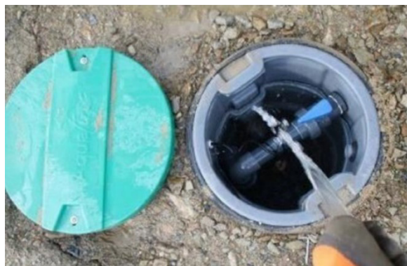
Entretien du poste de relevage
